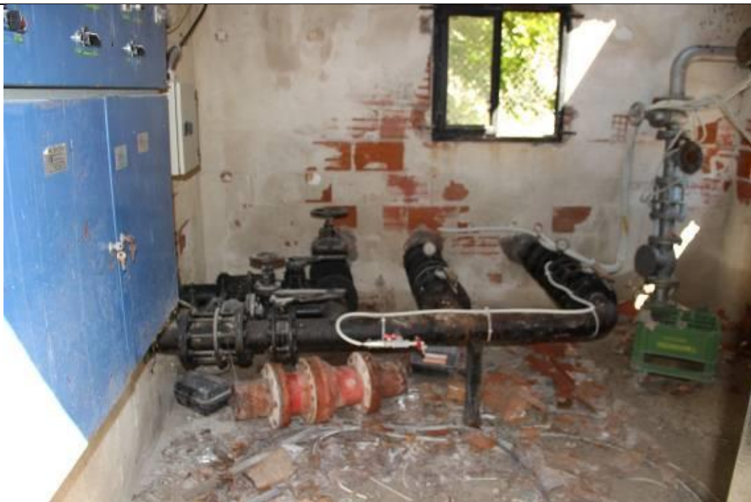
Συλλέκτης αντλιοστασίου στη θέση Αντλιοστάσιο-1 Φούρκας
