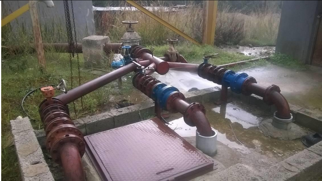
Συλλέκτης αντλιοστασίου στη θέση Λουτρά
