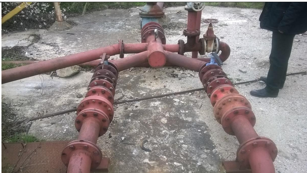
Συλλέκτης αντλιοστασίου στη θέση Αμπάρες
