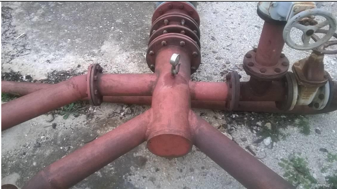
Συλλέκτης αντλιοστασίου στη θέση Αμπάρες
