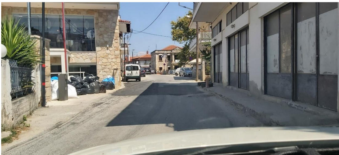
Ρηγματώσεις, λείανση επιφάνειας, απώλεια επιφανειακών υλικών ασφαλοτότητα.
