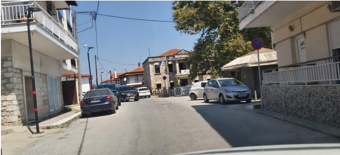
Ρηγματώσεις, λείανση επιφάνειας, απώλεια επιφανειακών υλικών ασφαλοτότητα.
