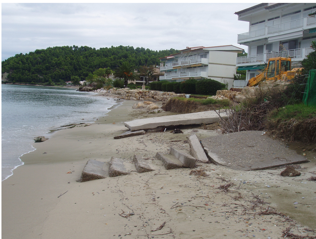
Φωτ. 6 Ζημιές σε παράκτιες ιδιοκτησίες στην περιοχή του βόρειου τμήματος της Παραλίας της Φούρκας
